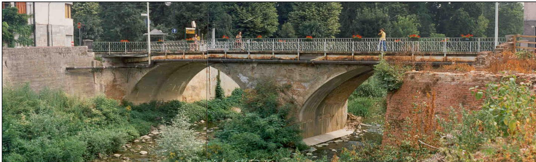
Stato pre intervento
